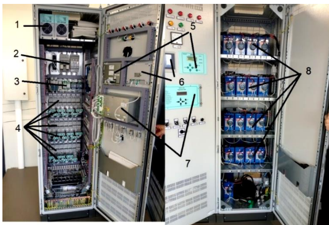
Рис. 1. Шкаф оперативного тока и шкаф аккумуляторных батарей: 1 - зарядно-подзарядное устройство; 2 – предохранители; 3 - набор реле; 4 - автоматические выключатели и дифференциальные датчики тока; 5 - контроллер зарядно-подзарядного устройства; 6 – панель оператора; 7 - терминал ЭКРА-СКИ; 8- моноблоки аккумуляторной батареи
